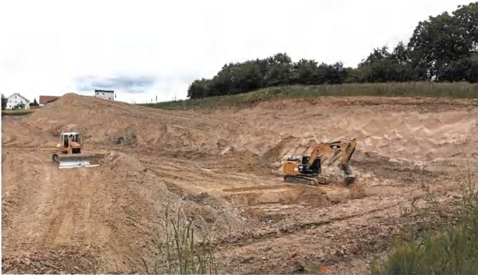
Zum Zeitpunkt der Untersuchung ist die gesamte Abbaufäche ökologisch schwerwiegend beeinträchtigt.
